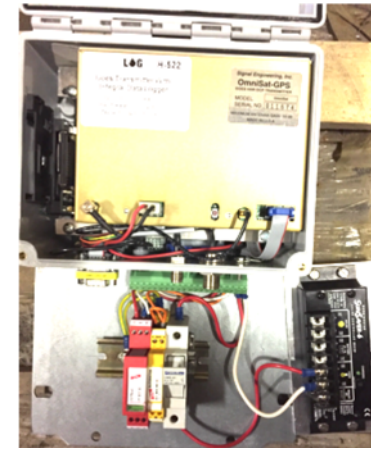
Data Logger Module
